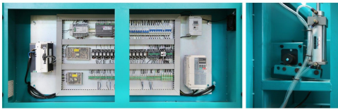
电控控制系统 Electric control system
